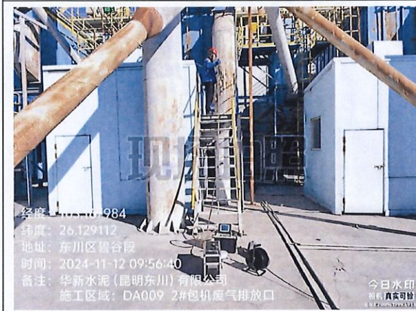
DA009 2#包机除尘器排放口 (FQ07#)
