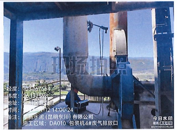
DA010 4#包机除尘器排放口 (FQ08#)
