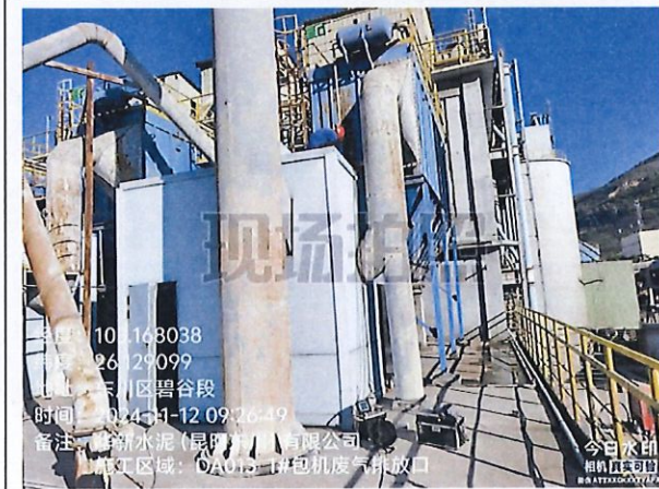
DA013 1#包机除尘器排放口 (FQ09#)
