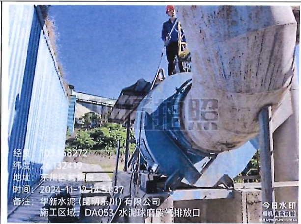
DA053 水泥球磨收尘器排放口 (FQ12#)
