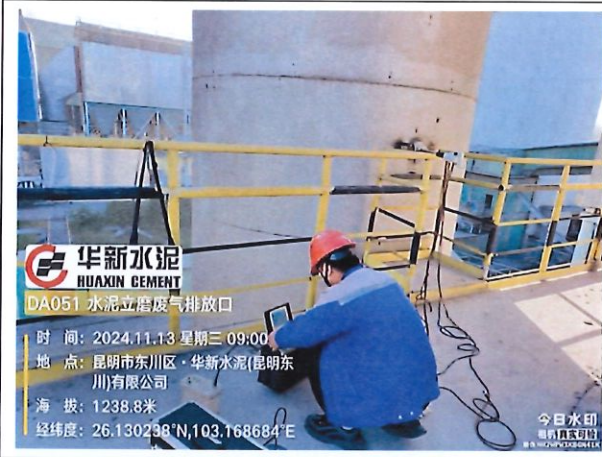
DA051 水泥立磨除尘器排放口 (FQ11#)
